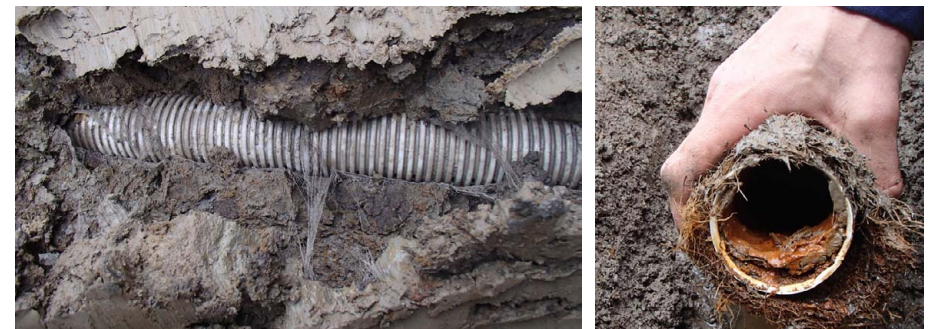
Kuva 7. Tulosten mukaan esipäällysteiden hajoaminen oli suuressa osassa kohteita pitkällä noin 10 vuotta ojituksen jälkeen. Vasemmalla ohuella suojakankaalla ja oikealla kookoskuidulla päällystetty putki. (Kuva: Markus Sikkilä.)
