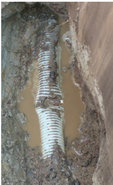
Rikkoutunut putki. (vas.)
